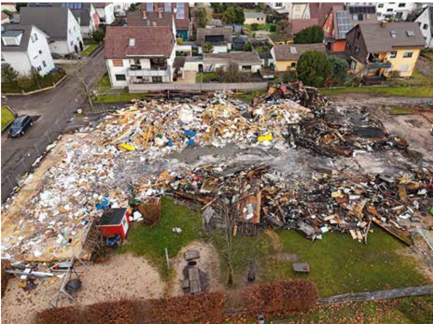
Der völlig zerstörte Kindergarten in Durmersheim: Das Gebäude musste zurückgebaut werden.
